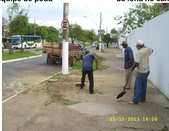
Figura 91 - Evidência de equipe de poda sem EPI (Av. João Alves Nascimento, Bairro Constantino)
