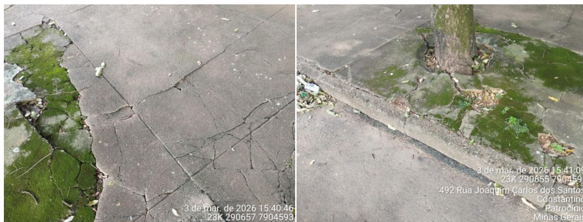
Foto 3: Raízes danificando a calçada.
