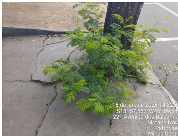
Foto 4: Danos causados à calçada.
