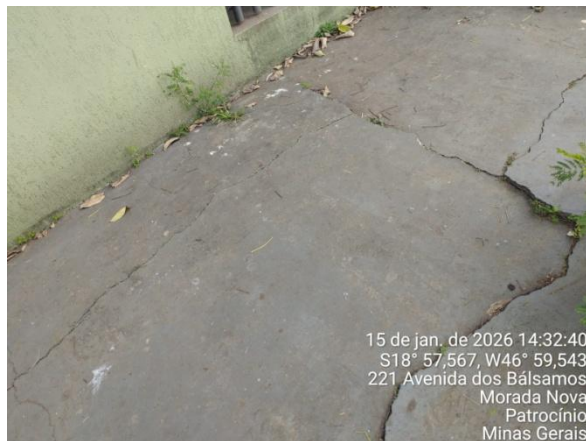
Foto 3: Danos causados à calçada.
