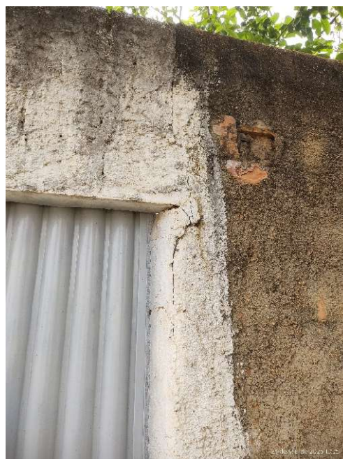
Figura 04: Danos ao muro da residência
