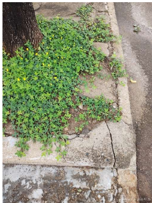
Figura 02: Danos causados ao passeio
