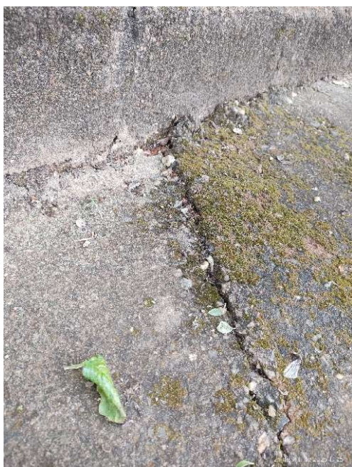
Figura 03: Rachaduras causadas pela expansão das raízes
