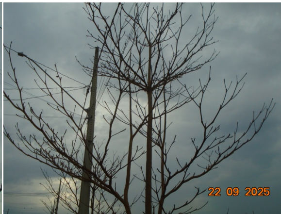
Foto 4: Galhos em contato com os fios de energia.
