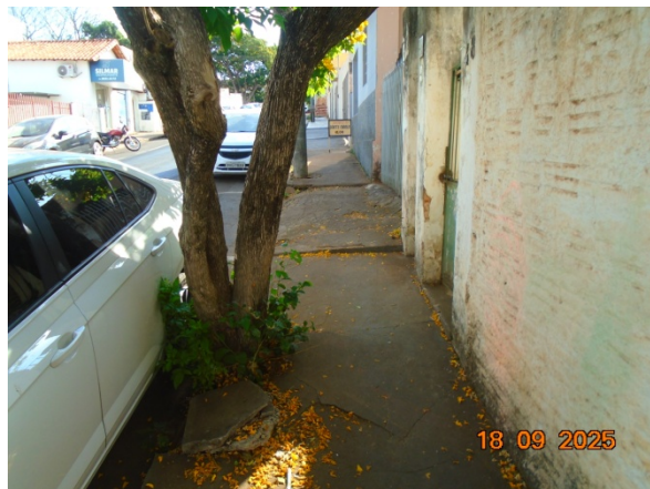
Foto 3: Danos causados a calçada.
