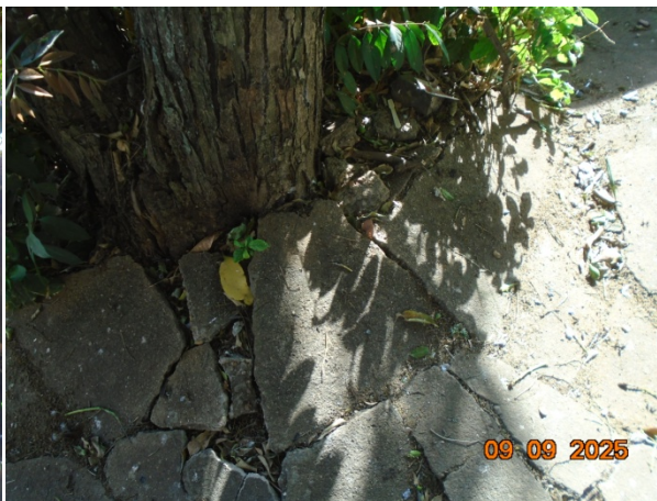
Foto 4: Mangueira danificando a calçada.
