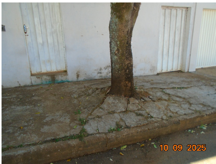
Foto 02: Danos causados à calçada pelas raízes da árvore.
