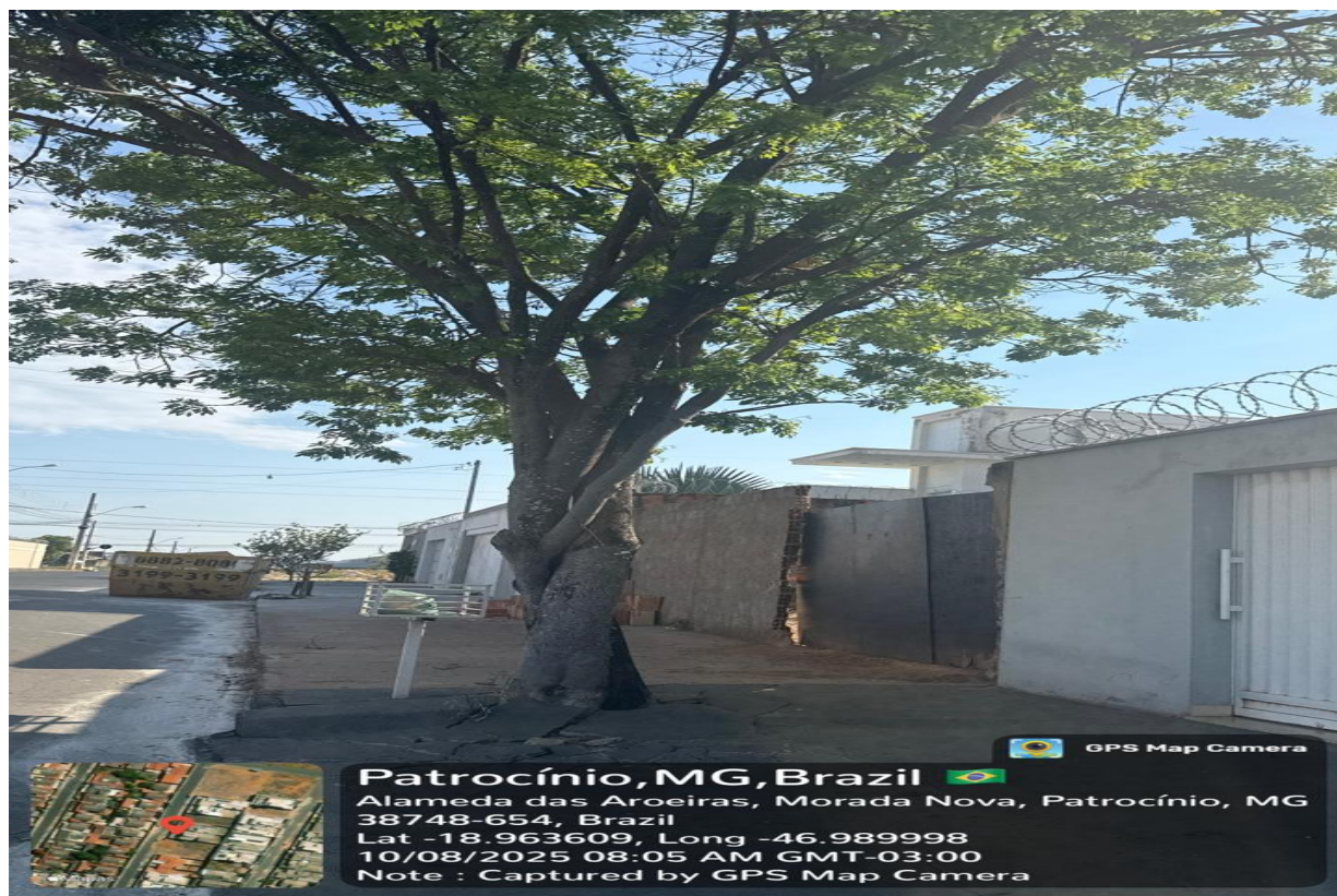
Foto 2: Raízes causando danos ao passeio. Fonte: SEMMA
