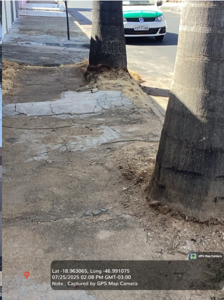
Foto 02: Observa-se os danos causados à
