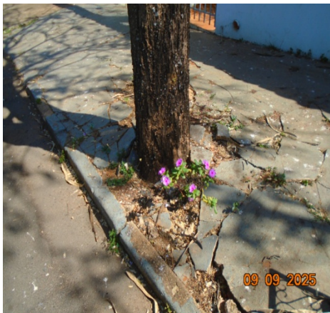
Foto 02 – Raízes danificando a calçada
