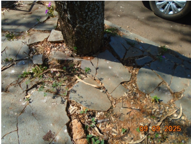
Foto 03 – Raízes danificando a calçada
