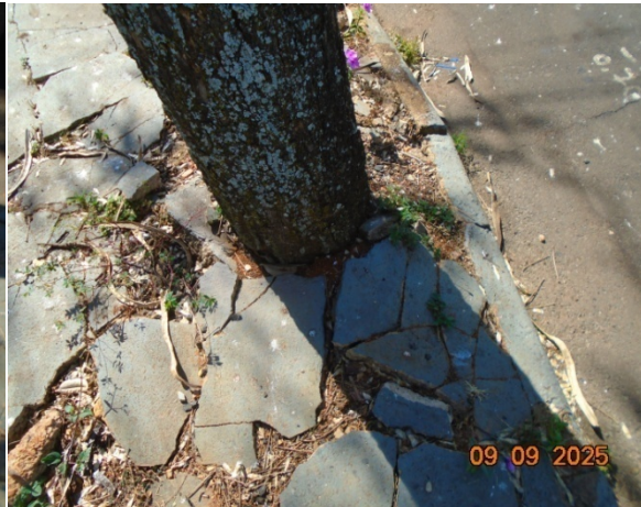
Foto 04 - Raízes danificando a calçada
