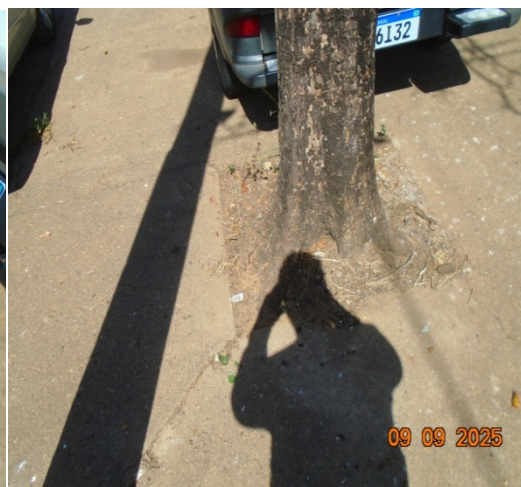
Foto 02 – Danos cusados pela árvore
