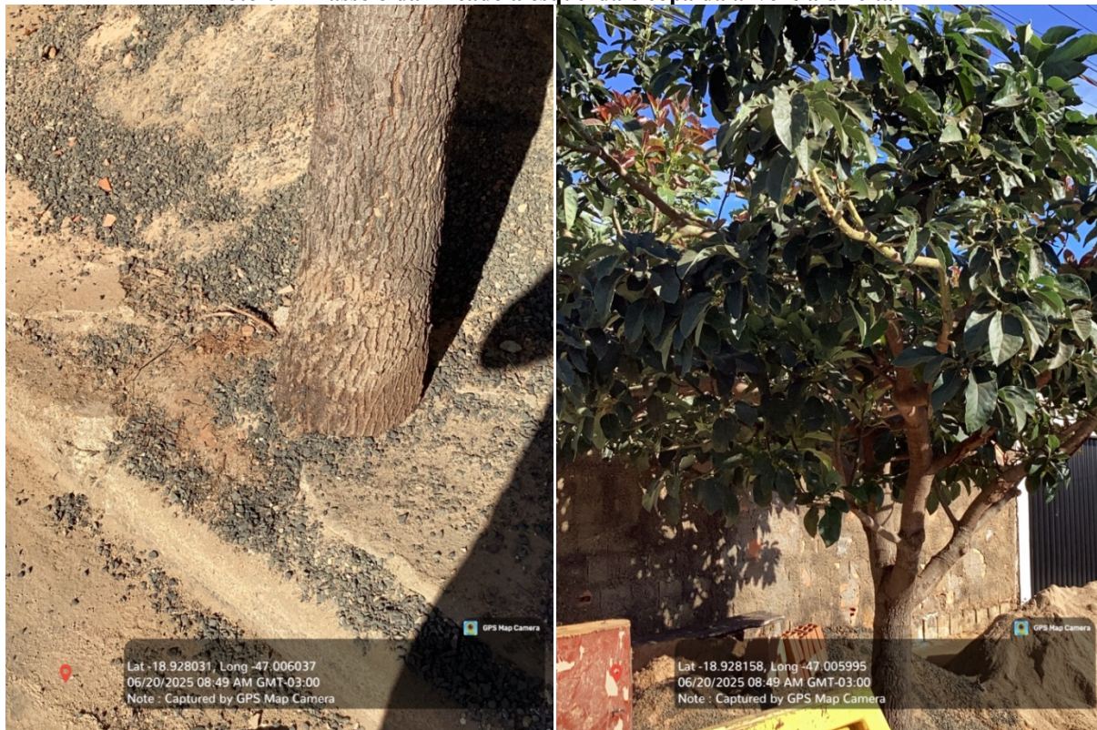
Foto 02 – Passeio danificado a esquerda e copa da árvore a direita
