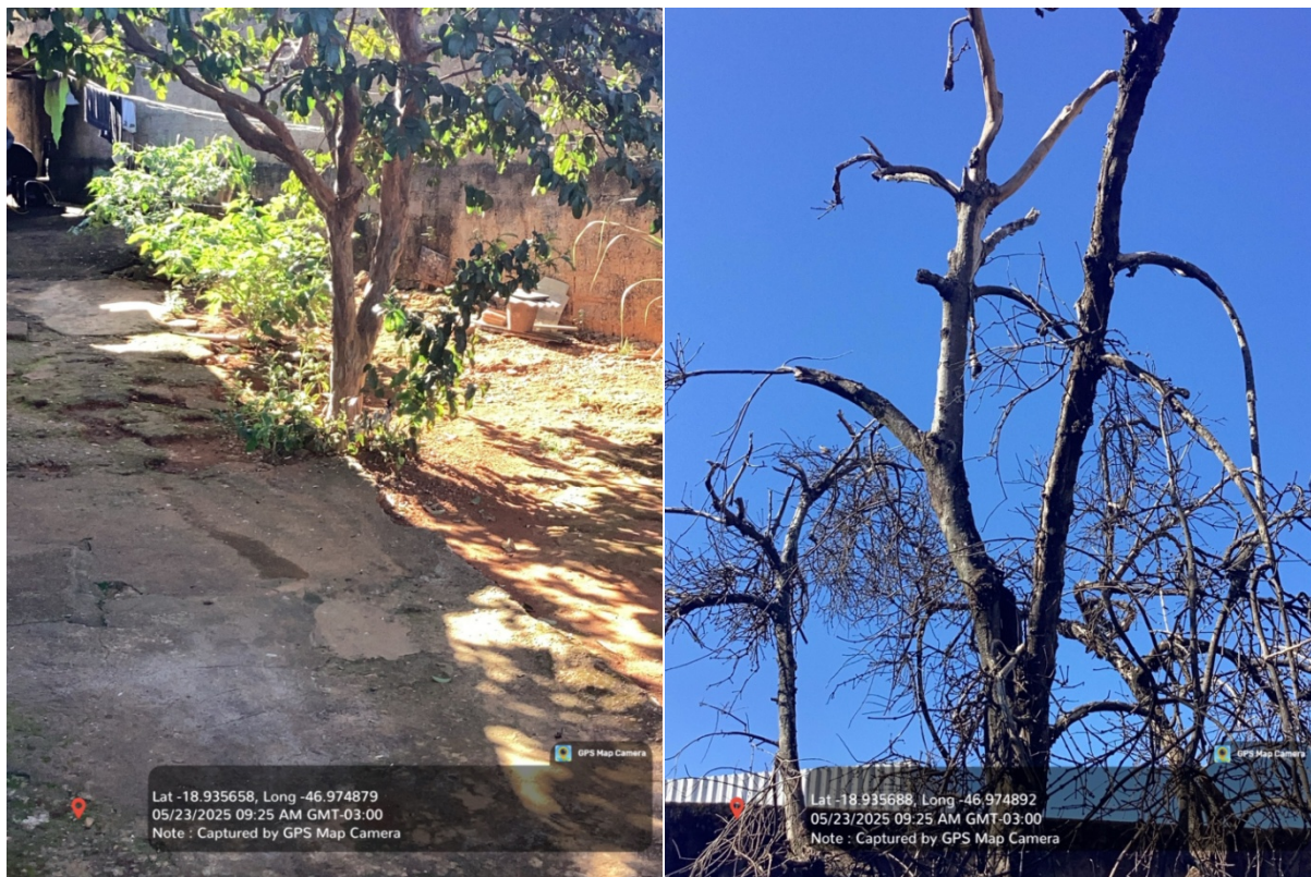
Foto 02 – Piso danificado a esquerda e árvore morta a direita
