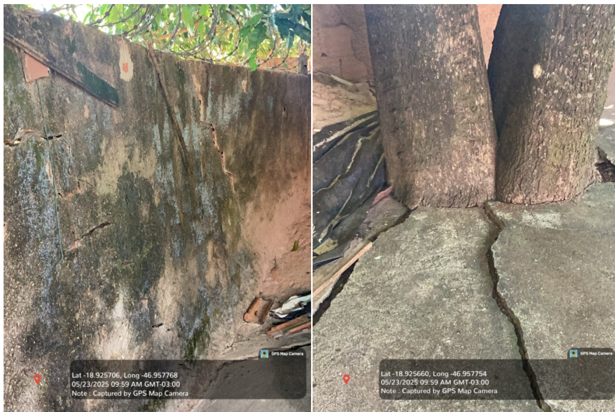
Foto 02 – Estrutura danificada em ambas as fotos
