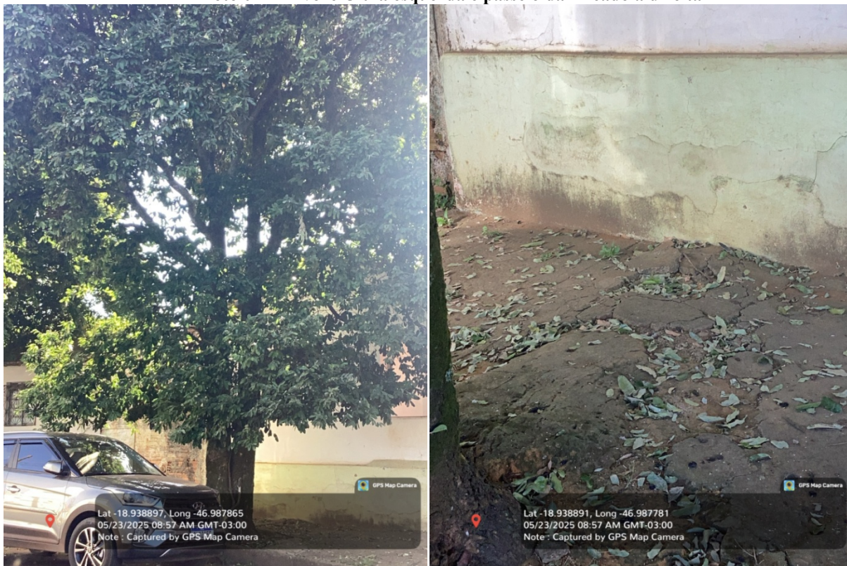
Foto 01 – Árvore Oiti à esquerda e passeio danificado a direita
