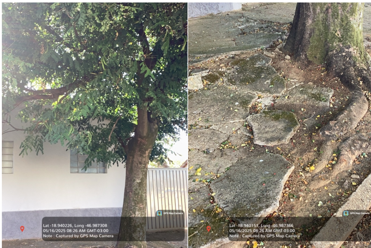
Foto 01 – Indivíduo arbóreo Olho de Pavão esquerdo e rachaduras provocadas por suas raízes à direita
