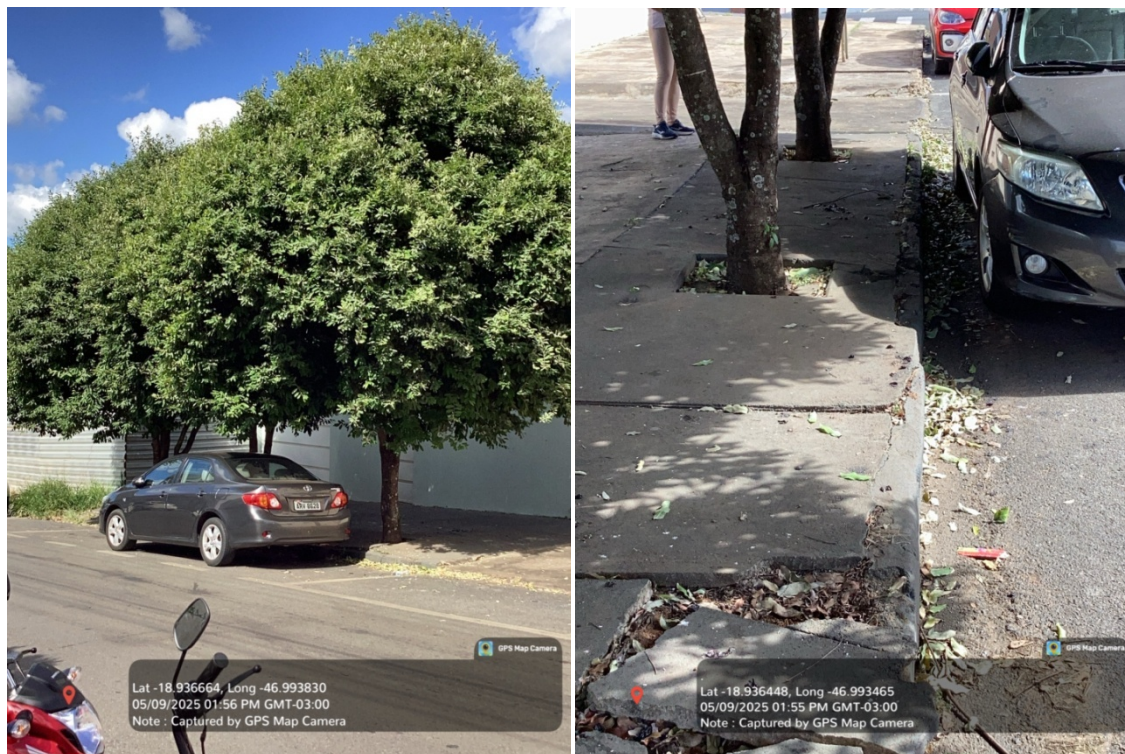
Foto 01 – Indivíduo arbóreo Oiti à esquerda e calçada danificada a direita
