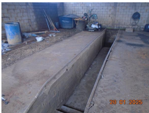
Foto 09: Lavador de veículos
