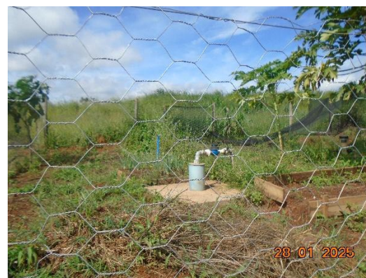
Foto 12: Instalações poço tubular
