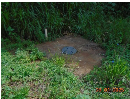
Foto 11: Sistema de tratamento de efluentes sanitários
