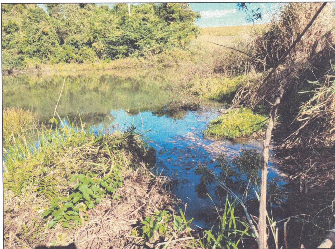
Figura 2. Fotografia evidenciando local de erosão no aterro por onde a água percola, Patrocínio - MG.
