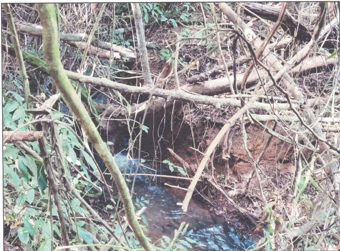
Figura 4. Fotografia evidenciando canais preferenciais de percolação da água do aterro, Patrocínio – MG.
