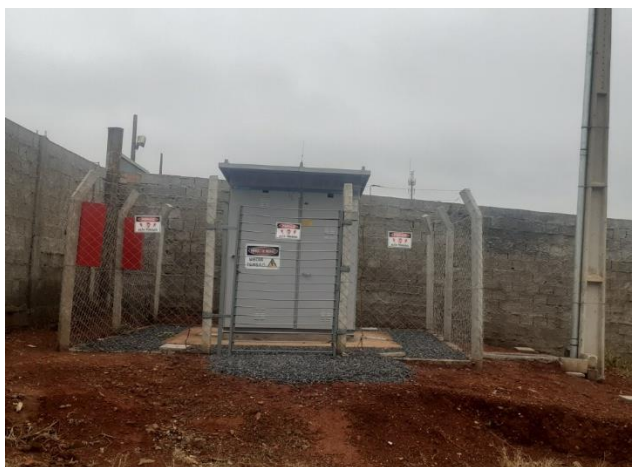
Foto 05: Subestação de energia
