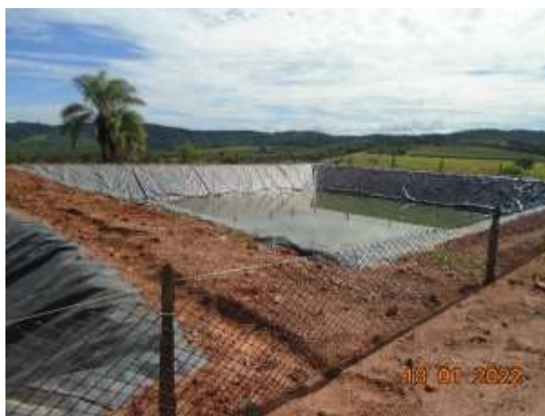
Figura 06: Lagoa de tratamento
