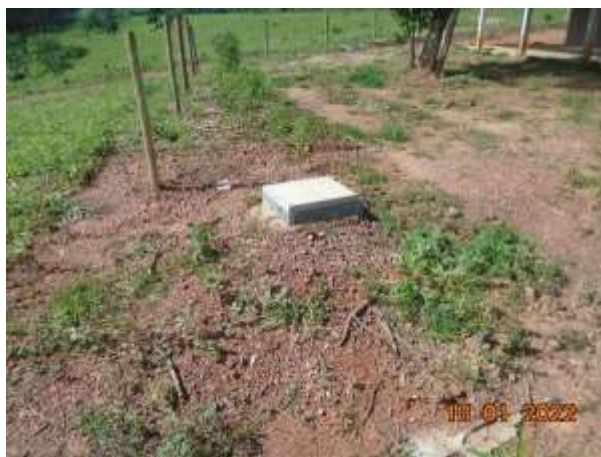
Figura 02: Caixa da fossa séptica
