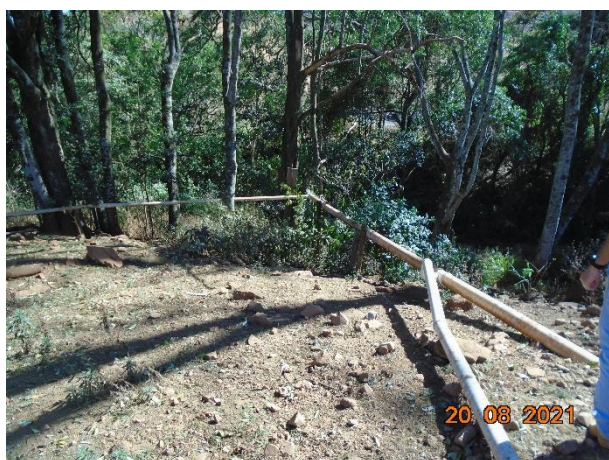
Figura 03: Tubulação de efluentes líquidos
