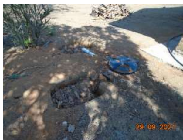
Foto 06: Biodigestor instalado recentemente
