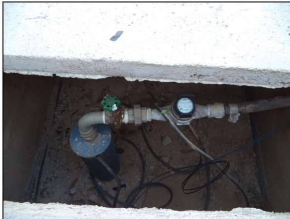
Figura 04: Poço tubular da portaria com hidrômetro
