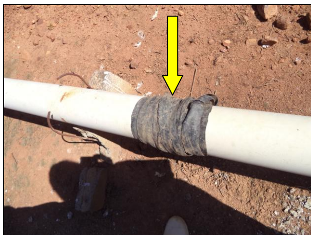
Figura 30: Tubulação envolvida com borracha, cuja finalidade seria para os encanamentos não se soltarem com a dilatação dos mesmos, devido à sua exposição ao sol
