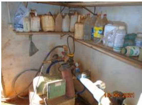
Figura 14: dentro da casa de máquinas
