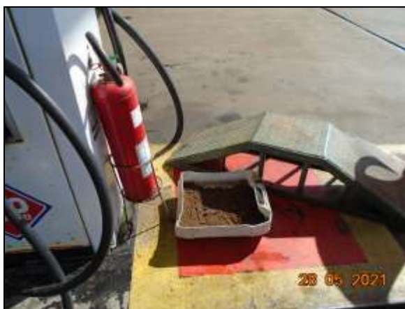
Figura 17: Recipiente contendo serragem para conter possíveis derramamentos de combustíveis no piso
