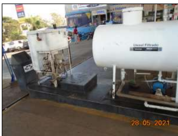
Figura 37: Câmara de contenção sob a unidade de filtragem
