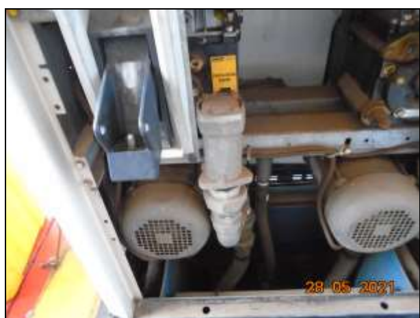
Figura 36: Câmara de contenção sob a unidade abastecedora/Check-valve
