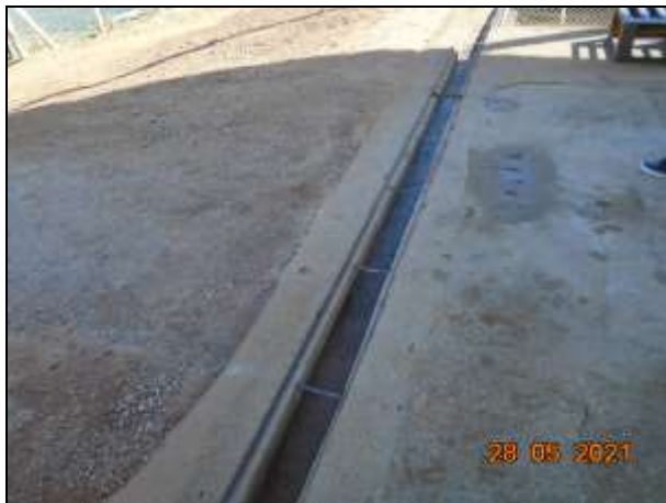
Figuras 42, 43 e 44: Canaletas de contenção de derramamentos de combustíveis
