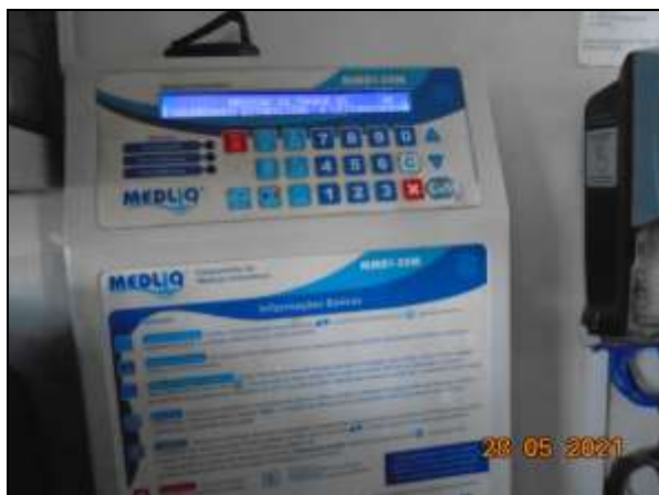
Figura 16: Sistema de medição volumétrica (controle de estoques automático) e detecção de vazamento
