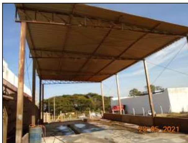
Figura 09: Lavador de veículos pesados. Notar impermeabilização do solo, cobertura do lavador e muretas de contenção no entorno
