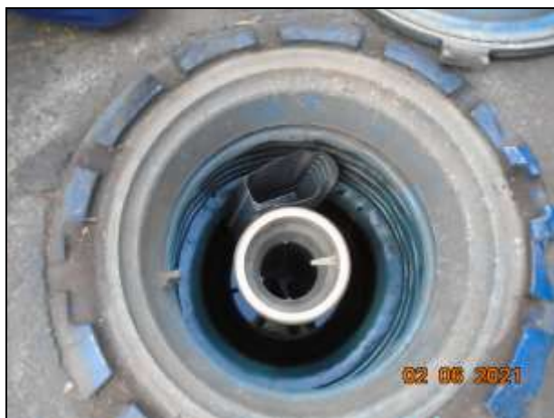
Figura 33: Câmara de contenção de descarga
