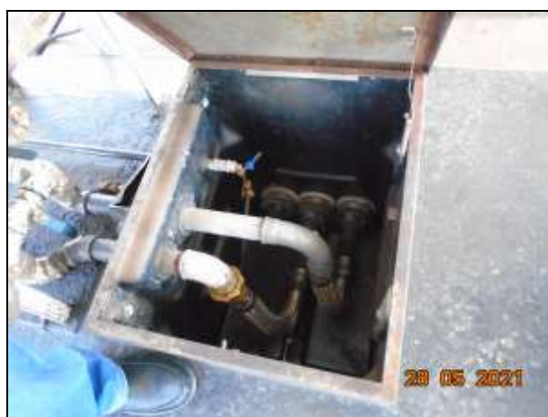
Figura 38: Câmara de contenção sob a unidade de filtragem
