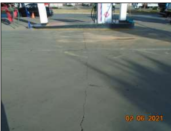
Figura 31: Observar presença de rachaduras na pista de abastecimento
