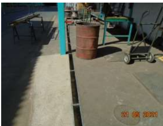
Foto 18: Caneleta de contenção na oficina
