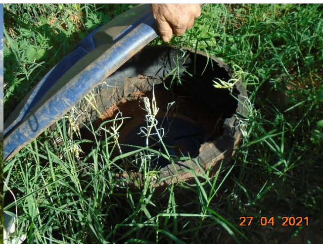
Foto 12: Biodigestor instalado para tratar efluentes sanitários
