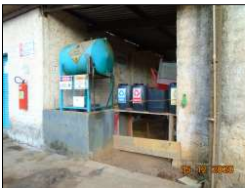
Figuras 29, 30 e 31: Pontos de abastecimento de combustíveis, notando-se que apenas na última imagem há bacia de contenção junto ao tanque de combustível
