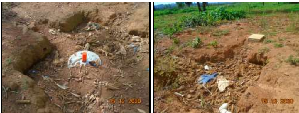
Figuras 40 e 41: Biodigestores instalados
