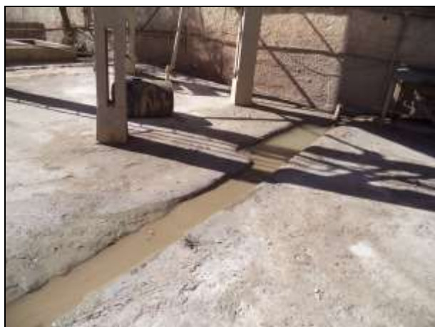
Figura 16: Observar canaleta de condução do efluente
