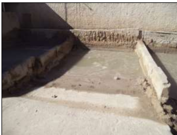
Figura 17: Caixas de decantação
