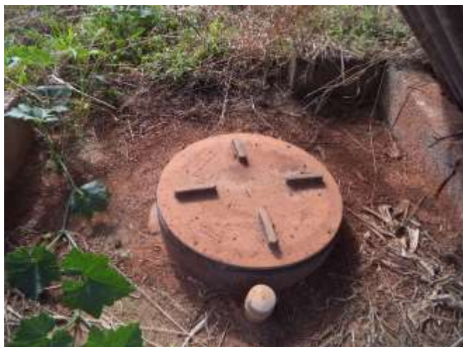
Foto11: Biodigestor para tratamento de efluentes
