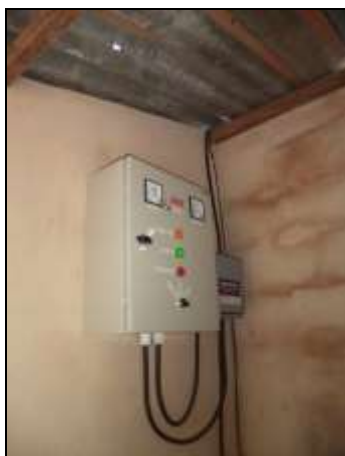
Figura 05: Horímetro poço tubular da portaria
