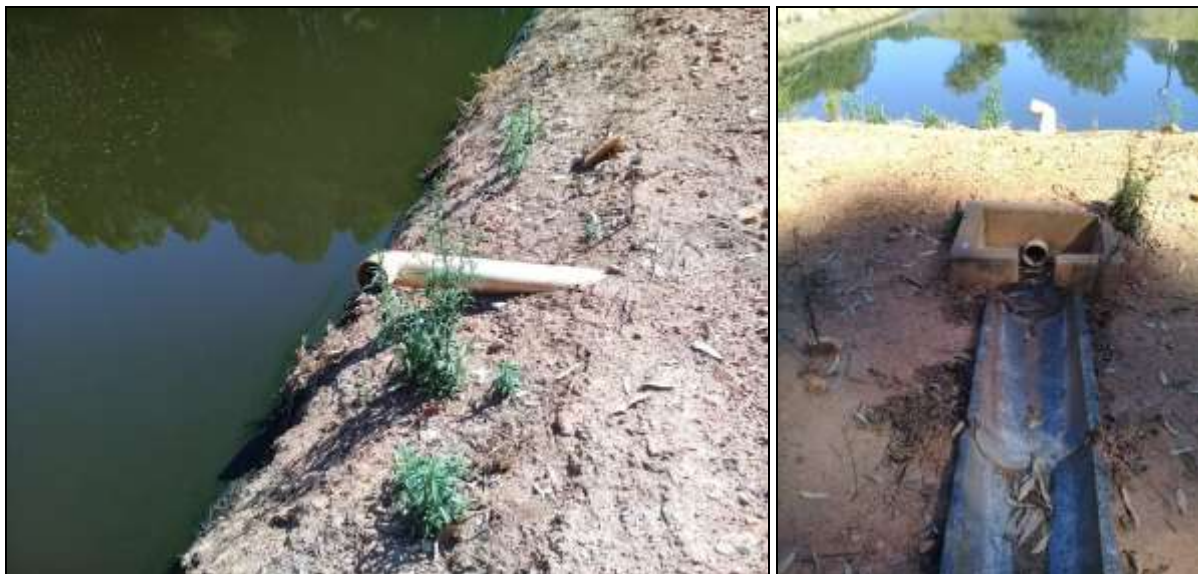
Figuras 35 e 36: Notar as evidências da interrupção do lançamento do efluente proveniente do tratamento ao curso d'água – Cano virado, presença de folhas e sedimentos na calha de condução do efluente
