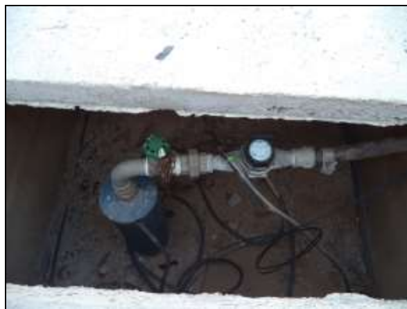
Figura 04: Poço tubular da portaria com hidrômetro
