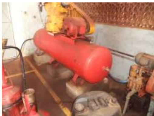
Figura 26: sala dos compressores e quadro de comando
