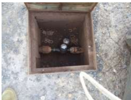
Figura 20: hidrômetro do poço
