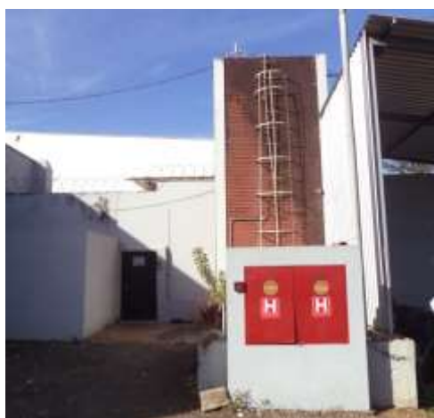
Figura 23: poço com reservatório
