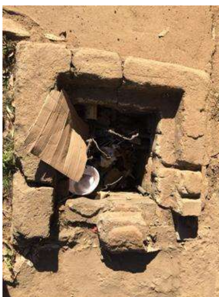
Figura 10: caixa de passagem sem tampa
