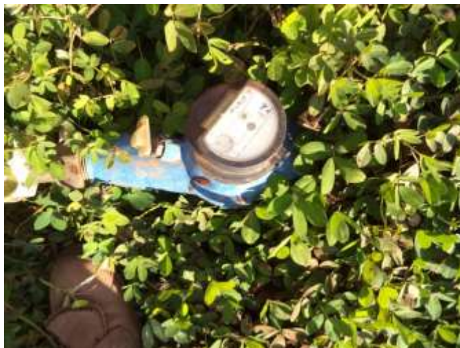
Foto 08: Poço Tubular, Faz. Abadia
