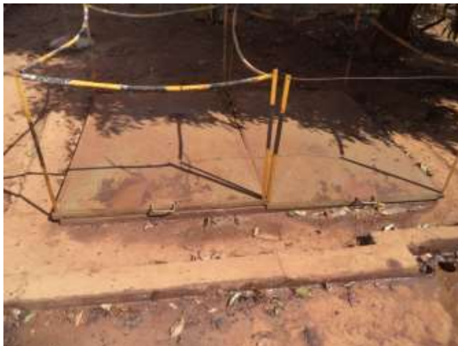
Foto 04: Caixa separadora de água e óleo
