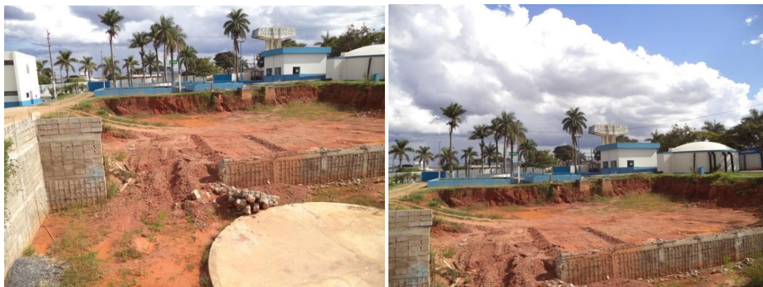
Foto 05 e Foto 06: área para os novos decantadores, obra paralisada desde 2018.
