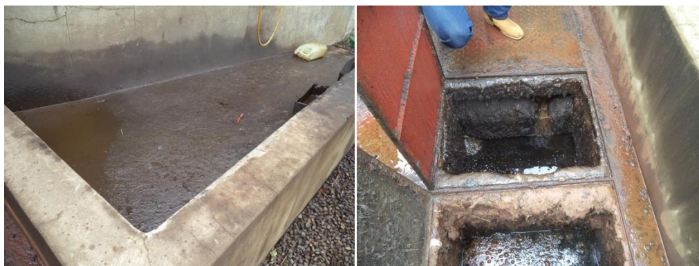
Fotos 03e 04: local onde se lavam peças e conseqüente CSAO, localizada em seguida ao lavador
