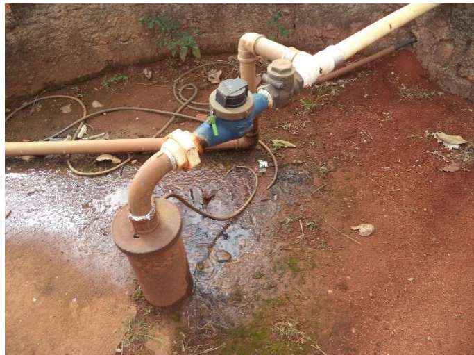
Foto 08: Poço Tubular, Faz. Recanto
