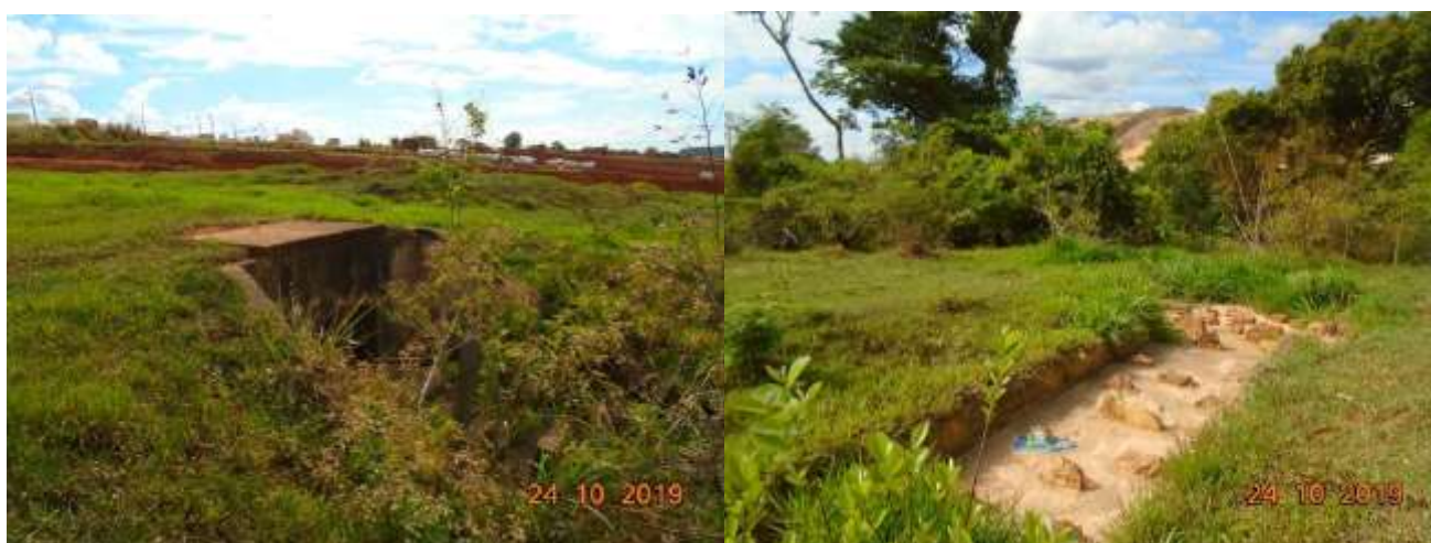
Fotos 7 e 8: local no início da APP onde vê observa o dissipador nº 1, o qual está concluído desde a primeira etapa do loteamento Vale Verde.
