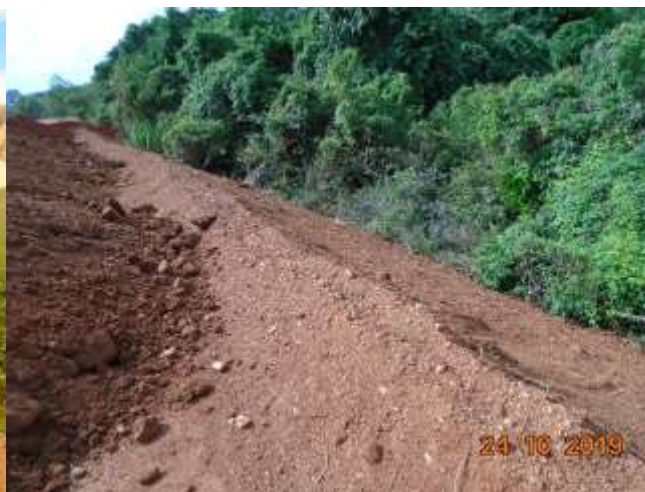
Foto 12: outro trecho mais adiante da mesma rua onde a saída do talude invade a APP.
