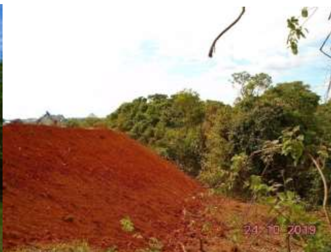
Foto 10: área onde o talude da rua Joaquim Barbosa Arantes inicia a invasão à área da APP.
