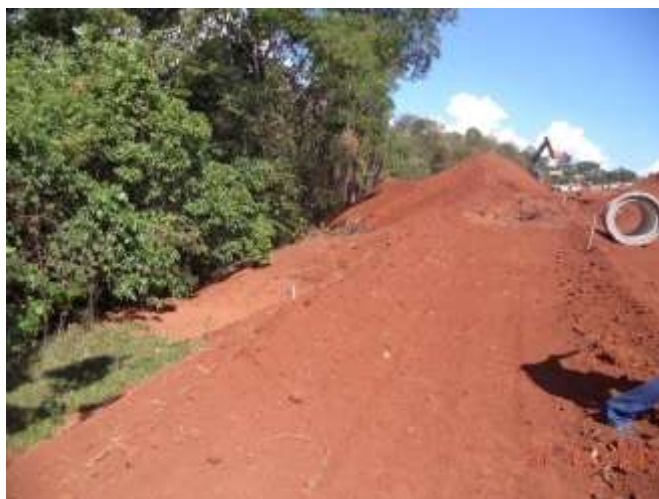
Foto 27: Rua Joaquim Barbosa Arantes, trecho quase final da rua. Observar que as raízes das árvores estão soterradas.
