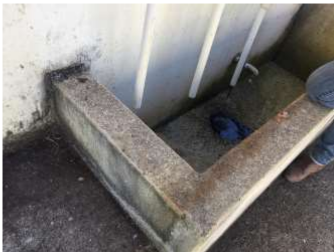
Foto 07: Registros externos amostradores de lodo
