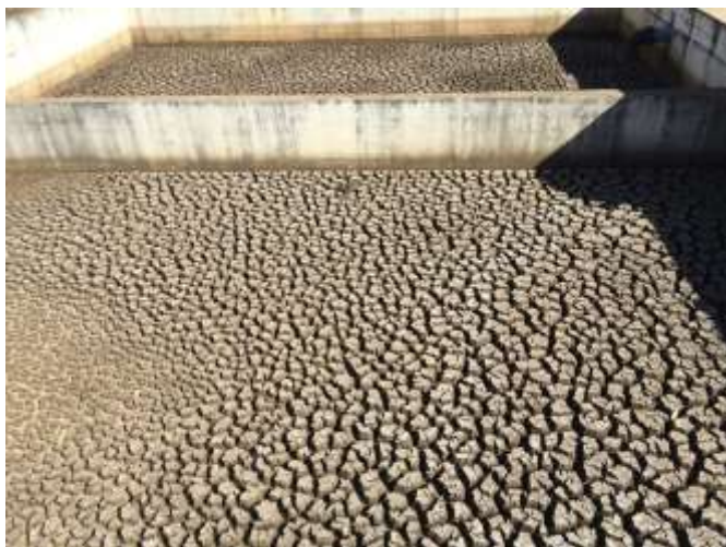
Foto 09: Leitos de secagem
