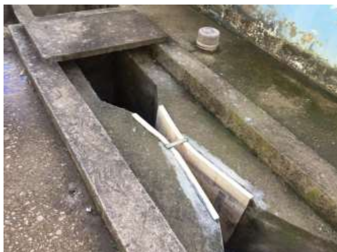
Foto 03: Tratamento preliminar - Calha Parshall
