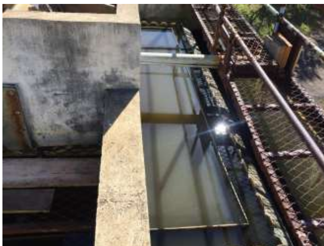
Foto 06: Reator UASB - decantador
