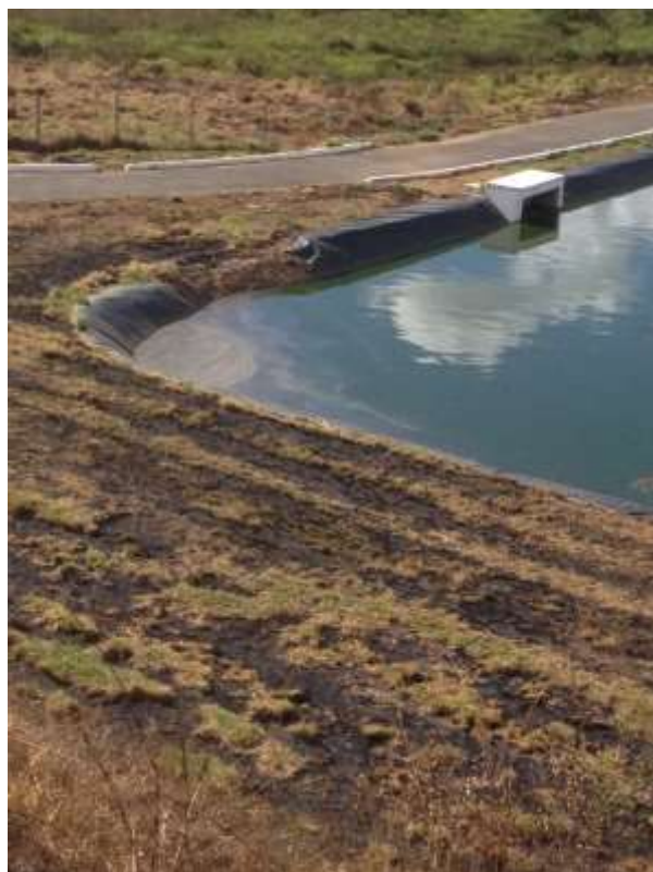
Foto 08: parte da geomembrana danificada
