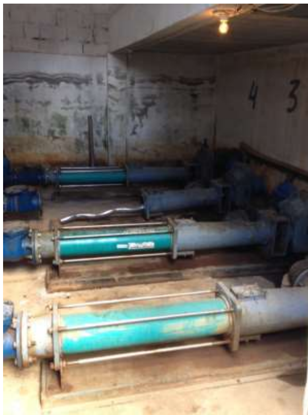
Foto 02: Conjunto de motobombas
