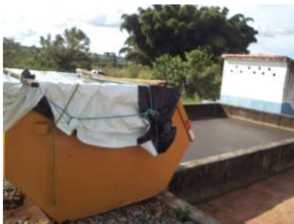
Figura 06: Observar caçamba de acondicionamento dos resíduos após a passagem pelos leitos de secagem
