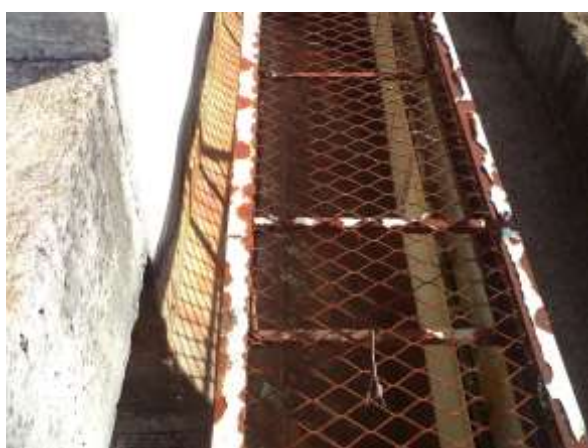
Figura 11: Estrutura metálica corroída
