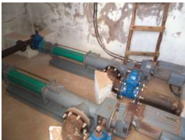
Figura 17: Conjunto de motobombas
