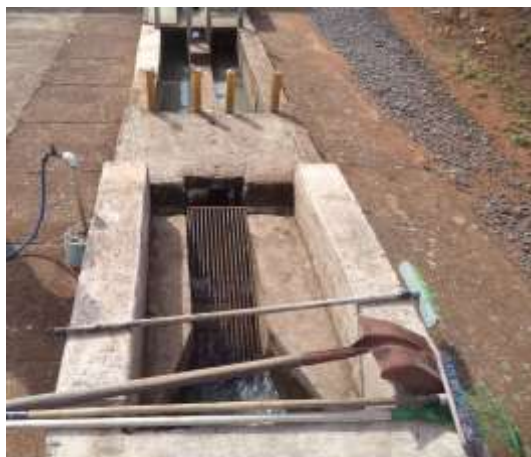
Figura 01: Gradeamento – Tratamento preliminar Chegada do efluente bruto
