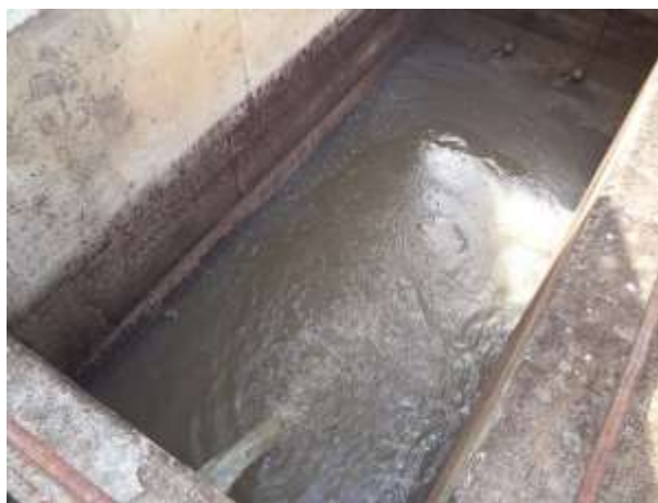
Figura 04: Poço de sucção
