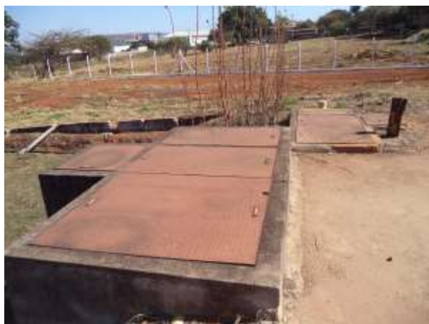
Figura 17: Caixas separadoras de água e óleo
