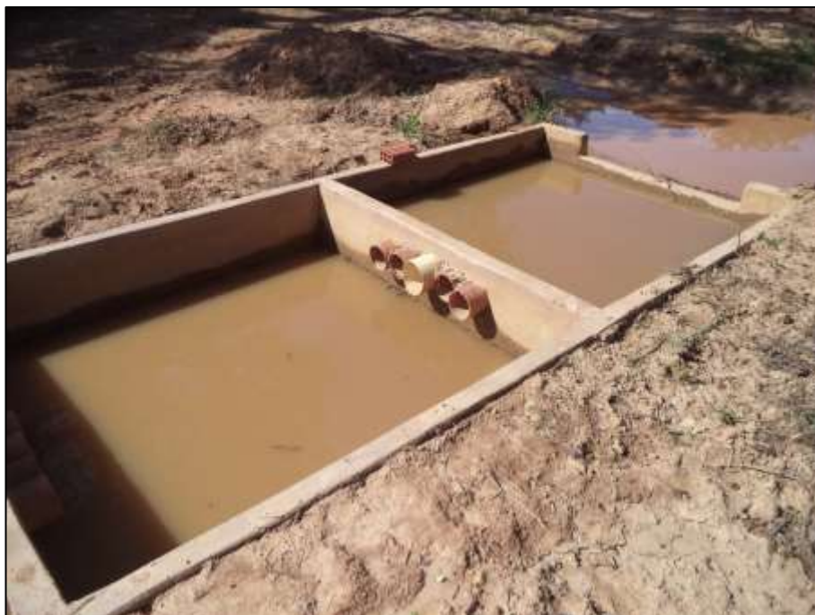
Foto 02: Caixa de decantação em APP.
