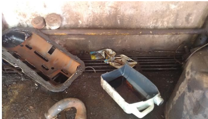
Figura 16: Observar canaletas de contenção do óleo e piso impermeável onde ocorre esgotamento do óleo dos motores
