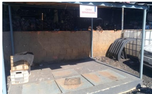
Figura 11: Caixa separadora de água e óleo
