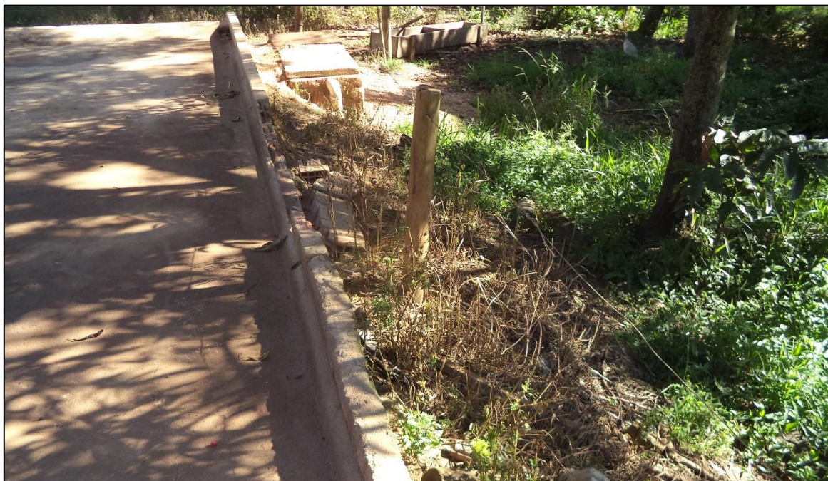
Foto 05: Pista de abastecimento com CSAO ao fundo, detalhe para parte da mureta de contenção danificada.
