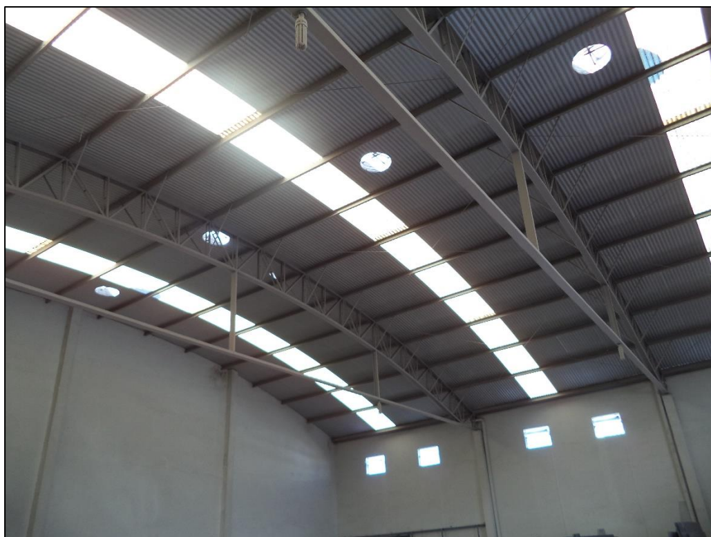
Foto 04: Vista dos exaustores presente no empreendimento.
