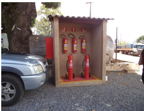
Figura 02: Extintores na área dos tanques
