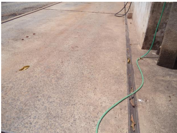
Figura 3: Canaletas da pista de abastecimento
